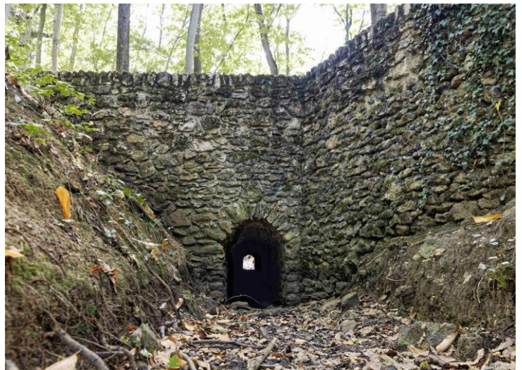
L'ouvrage d'art du Croisement permettait à l'eau du réseau « aérien » de passer au-dessus du réseau « technique ». Ce curieux aqueduc de 29 m a été restauré en 2007. (30 septembre 2022).
