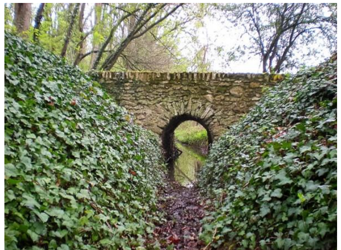
Le réseau « technique » sous le beau pont de la Fosse Renault restauré en 2007 (26 avril 2016).
