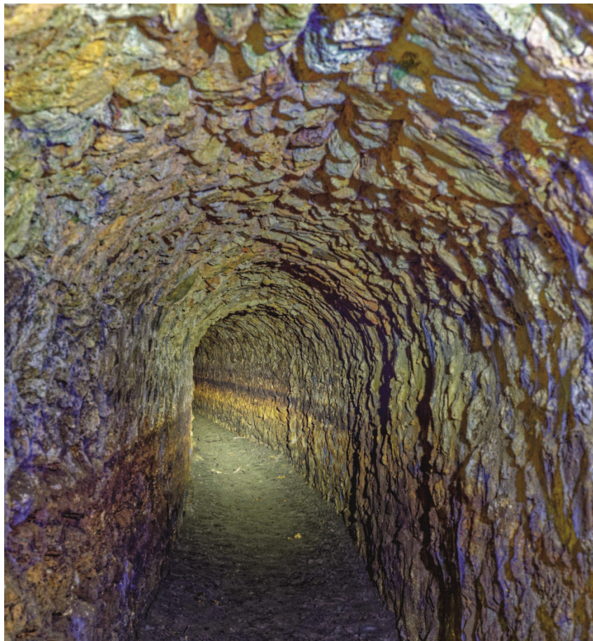
Aqueduc de la Grange Dame Rose: sa galerie est formée de deux piédroits en meulière, espacés de 90 cm, surmontés d'une voûte en plein cintre, exploré sur 710 mètres © Arhyme
