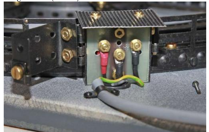
Bild 9: Stromanschlusskasten mit Tür.
