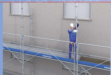
7 - Mise en place des plinthes, des montants de 2,00 m et des moises du niveau supérieur. Placer la troisième lisse dans la maille d'accès.
