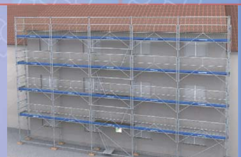
12 - Mise en place du filet ou grillage de protection. Vérification de la conformité de l'échafaudage vis-à-vis du plan.
